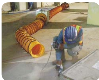
塵埃控制設備
